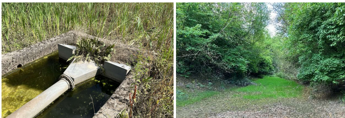
Abbildung 5: Zustand bestehender Retentionsbecken (links) und RRB 2 A+B (rechts) (Quelle: Eigenes Foto)
